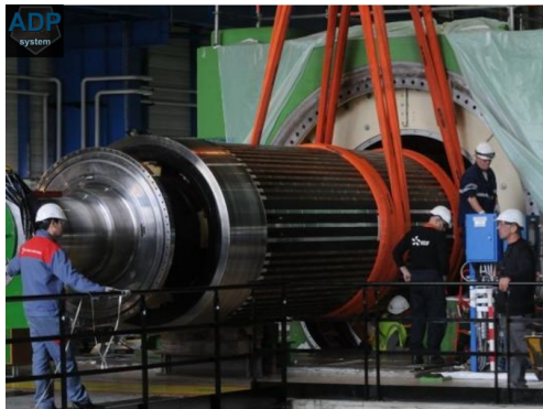
Rotor d'une centrale hydroélectrique.
